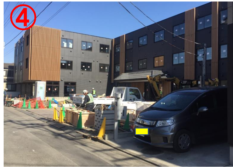
▷③のT字路から60m、右側に3階建てのライブラリ橋本二番館！！
